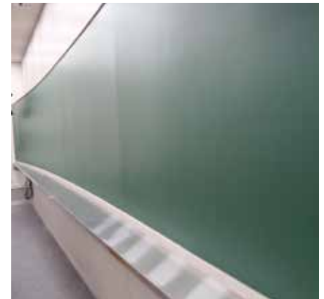
강의실 좌우 끝에서도 잘 보이도록 곡면 와이드 칠판 설치
